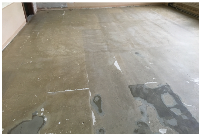
Un ancien support nécessitant une réhabilitation.
